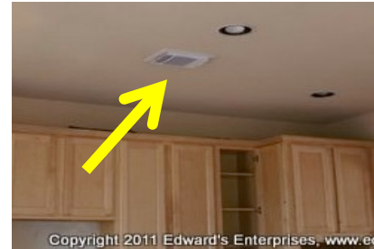
Ceiling exhaust fan
