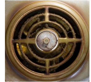
Wall exhaust fan
